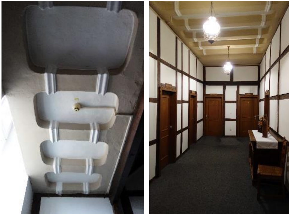
Links: Kölner Decke mit profilierten Stuckwülsten im 1. OG; rechts: Fachwerkbinnenkonstruktion, Kölner Decke, 1. OG.
